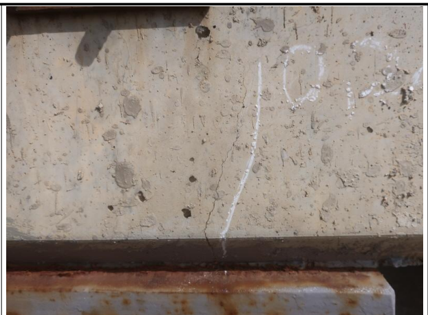
S4 거더 균열(0.3mm미만)
