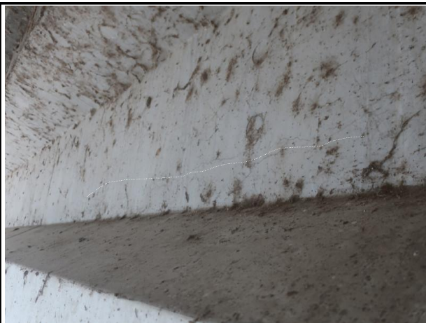
S3 거더 균열(0.3mm미만)
